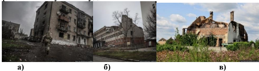
Рис.1. Фото будівель різного ступеню руйнування внаслідок бойових: а – пошкоджена будівля у місті Соледар; б – зруйнована будівля у місті Бахмут; в – зруйнована приватна будівля у селі Мощун.
