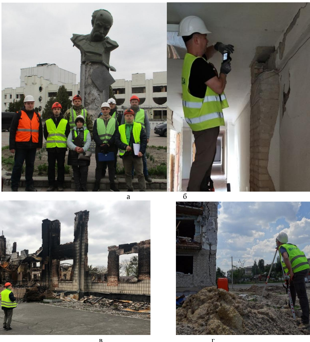
Рис. 1. Обстеження об'єктів нерухомості в смт. Бородянка: а – експертна група обстеження КНКУБА; б – обстеження несучих конструкцій місцевого палацу культури; в – обстеження зруйнованої будівлі центру реабілітації ЮНЕСКО, г – обстеження житлової будівлі.
